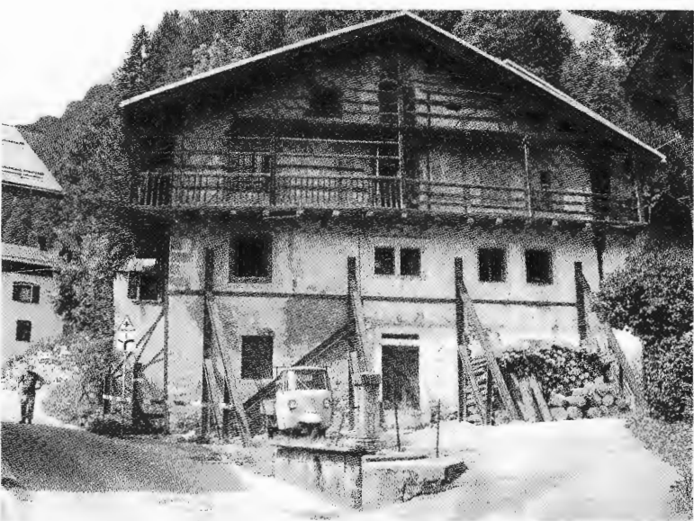
Fig. 3 – Una casa di abitazione lesionata in seguito a cedimento del suolo per processi di soluzione dei sottostanti gessi a Andrich, Agordino. A damaged building, following the subsidence caused by the solution of the underlying gypsum layers in the village of Andrich (Agordo, Dolomites).
