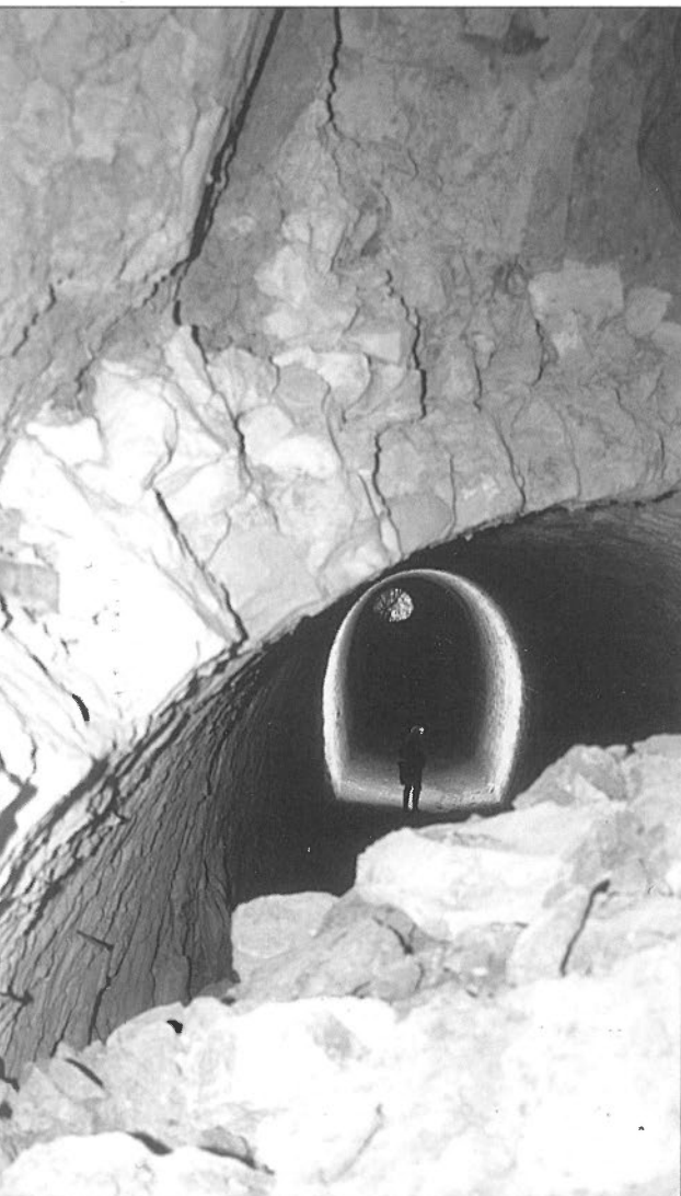
Gruppo Speleologico Emiliano "La ferrovia incompiuta Modena-Pavullo" Galleria del Poggio - Particolare della volta nella zona di frana. Foto U. Gibertini
