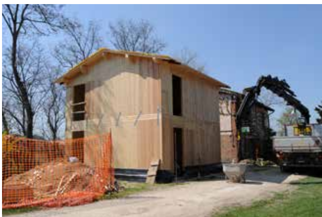
Fig. 2 – I lavori di ampliamento del Centro Visita Rifugio Ca' Carnè (foto M. Costa).
